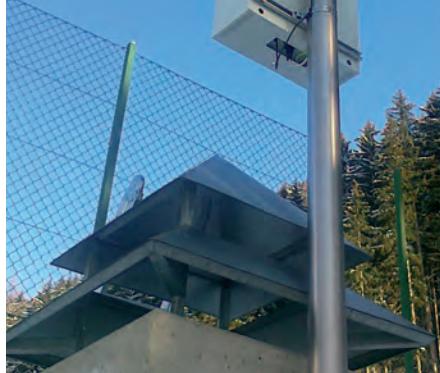
Sistema Radar - Austria
